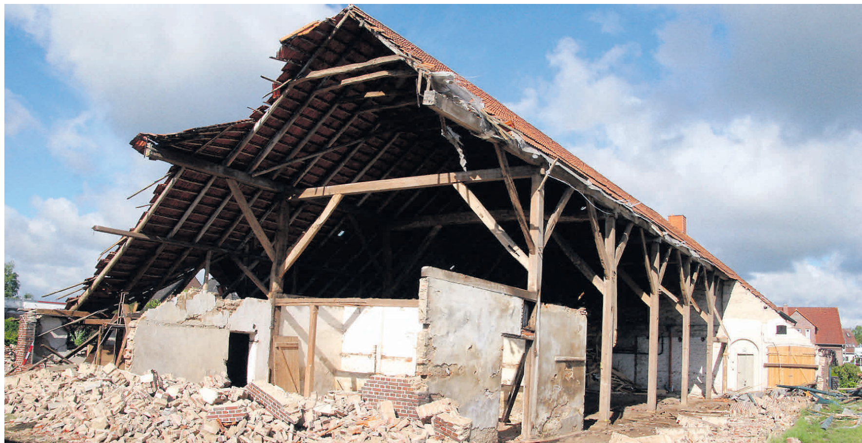
Das ehemalige Bauernhaus an der Bohlenberger Straße 24 in Zetel wird gerade abgerissen.
