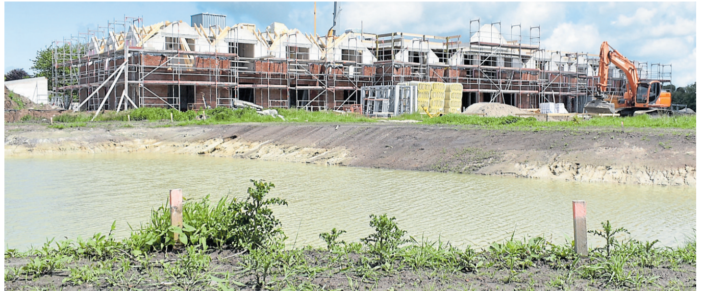
In der Nähe des bereits fertiggestellten Regenrückhaltebeckens liegt der Neubau des Wohnparks im Zeitplan. Im Frühsommer 2023 soll das Haus eröffnet werden.
