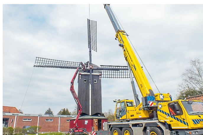
Mit einem Kran werden die Flügel an der Bockwindmühle Dornum montiert. BILD: MICHAEL RÖTHLING
