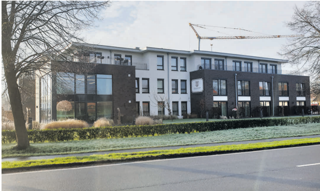
Ein Baukran steht hinter dem Wohnpark des Pflegebutlers in Apen: Auf dem rückwärtigen Gelände entsteht ein zweites Apartmenthaus für betreutes Wohnen. BILD: DORIS GROVE-MITTWEDE
