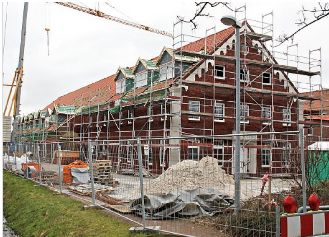
60 Meter lang und bis zu 18 Meter breit ist der Erweiterungsbau der Pflegeeinrichtung „Peter Ei“ in Großheide. FOTOS: GERKEN
